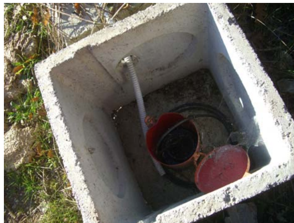
Foto 2 – Dreno AP.10.07 nei pressi della Galleria Sirino.
