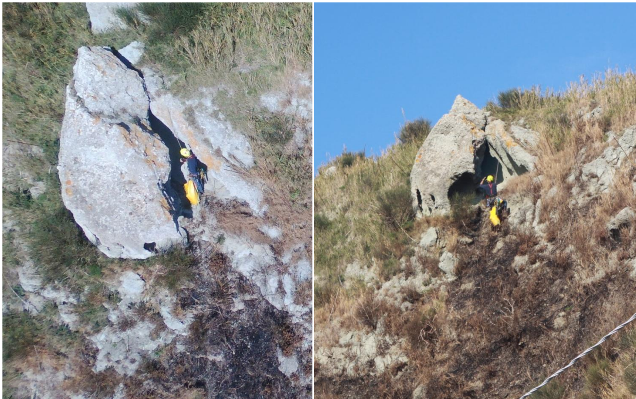
Figura 29: area1 - settore destro) massa di grandi dimensioni in ribaltamento, lungo discontinuità del set1 e scalzata al piede e alle spalle per effetto dell'erosione eolica al piede.
