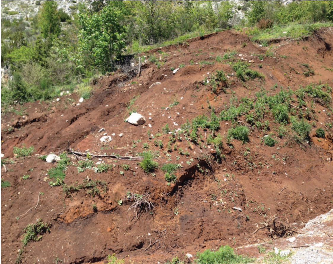
Foto 8 - Vista terreno franoso lato monte (da asportare)
