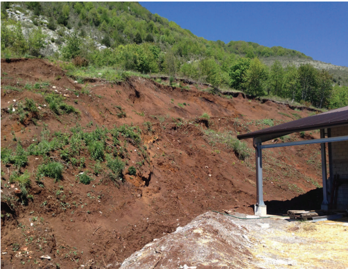
Foto 7 – Vista terreno franoso adiacente al capannone (da asportare)
