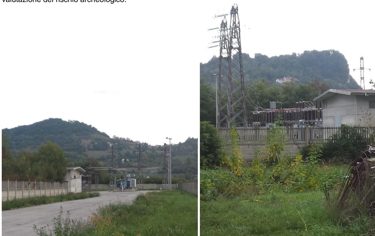
Figura 3 - Cabina primaria ENEL di Ceva, punto di partenza della linea aerea
