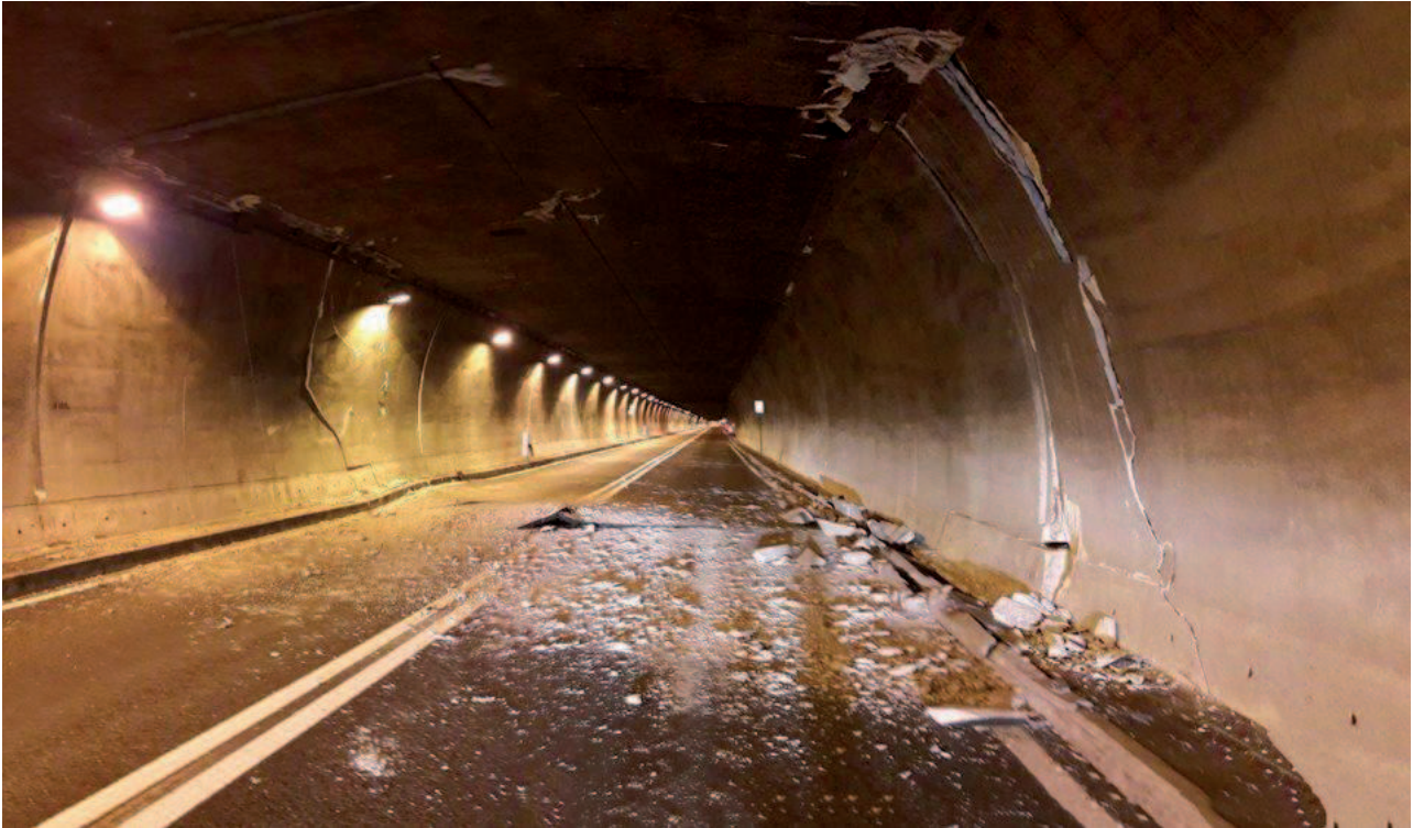
Figura 10: frattura nel rivestimento di una galleria nei pressi di Norcia in seguito ai terremoti succedutisi dal 24 agosto 2016 nell'Italia Centrale. E' intuibile l'entità dei danni che fenomeni simili possono causare su tubazioni verticali ed orizzontali e sugli impianti anche se realizzati nel rispetto della legge antisismica vigente.
