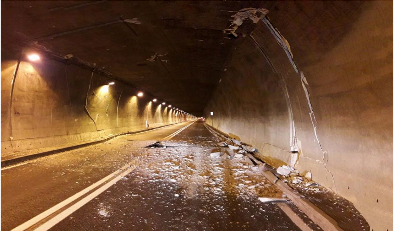
Figura 10: frattura nel rivestimento di una galleria nei pressi di Norcia in seguito ai terremoti succedutisi dal 24 agosto 2016 nell'Italia Centrale. E' intuibile l'entità dei danni che fenomeni simili possono causare su tubazioni verticali ed orizzontali e sugli impianti anche se realizzati nel rispetto della legge antisismica vigente.
