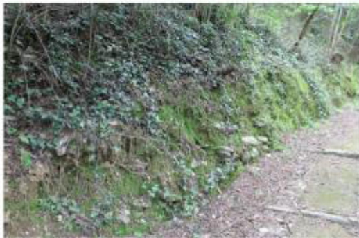
Scarpata e margine stradale Stato di manutenzione: P Localizzazione di massima: Y: 4926422.07 m N X: 491874.25 m E
