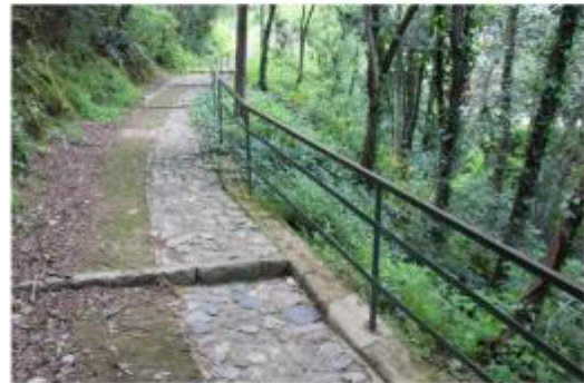
Parapetto in ferro Stato di manutenzione: P Localizzazione di massima: Y: 4926422.07 m N X: 491874.25 m E
