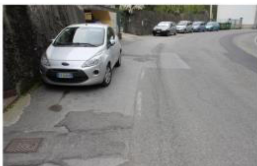
Margine stradale Stato di manutenzione: D Localizzazione di massima: Y: 4930365.34 m N X: 489518.10 m E
