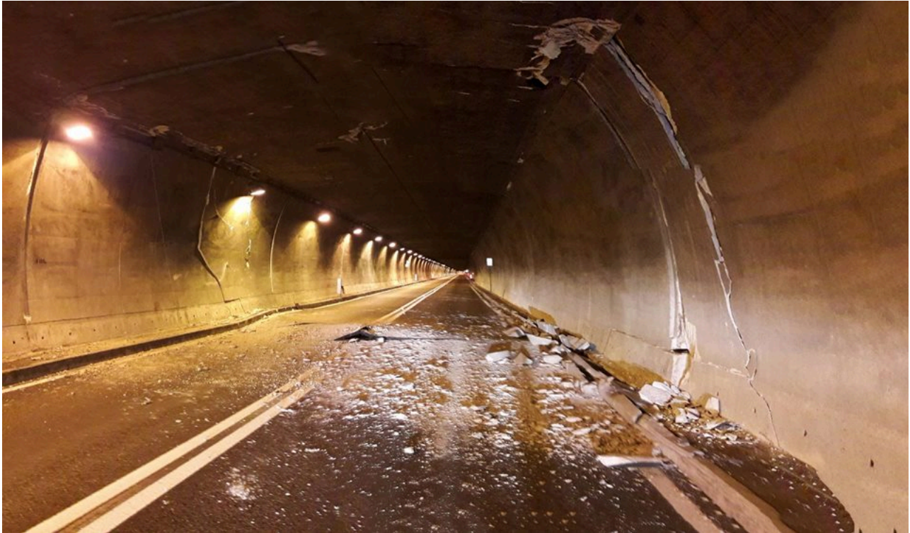
Figura 7: frattura nel rivestimento di una galleria nei pressi di Norcia in seguito ai terremoti succedutisi dal 24 agosto 2016 nell'Italia Centrale. E' intuibile l'entità dei danni che fenomeni simili possono causare su tubazioni verticali ed orizzontali e sugli impianti anche se realizzati nel rispetto della legge antisismica vigente.
