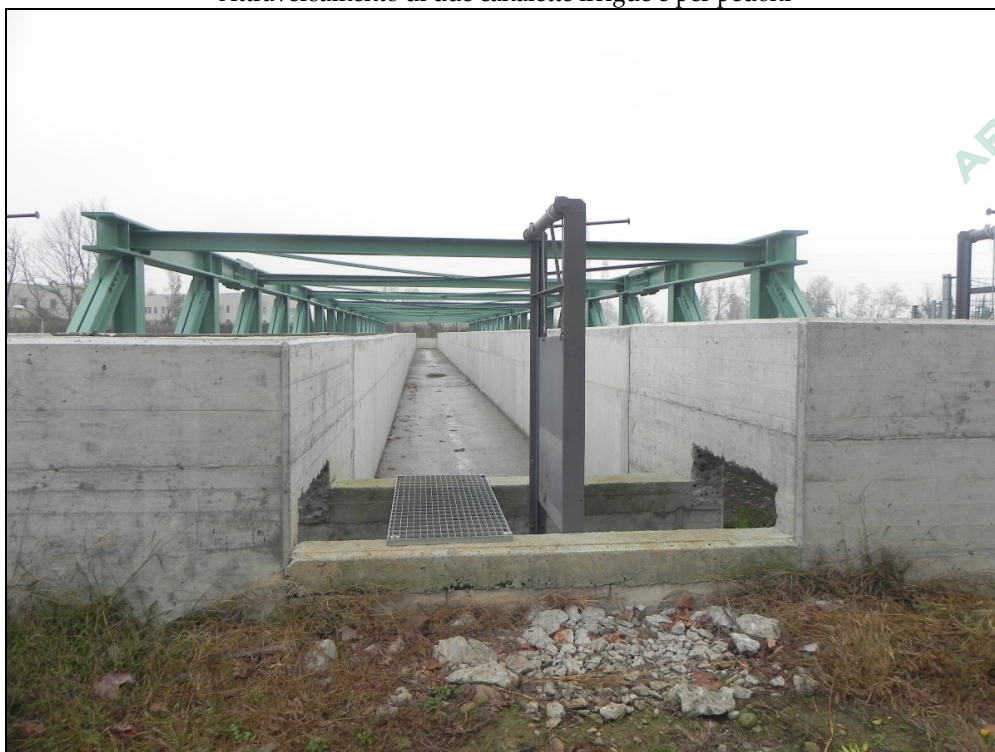
Modificando questo accesso si può sfruttare il corridoio fra e due canalette
