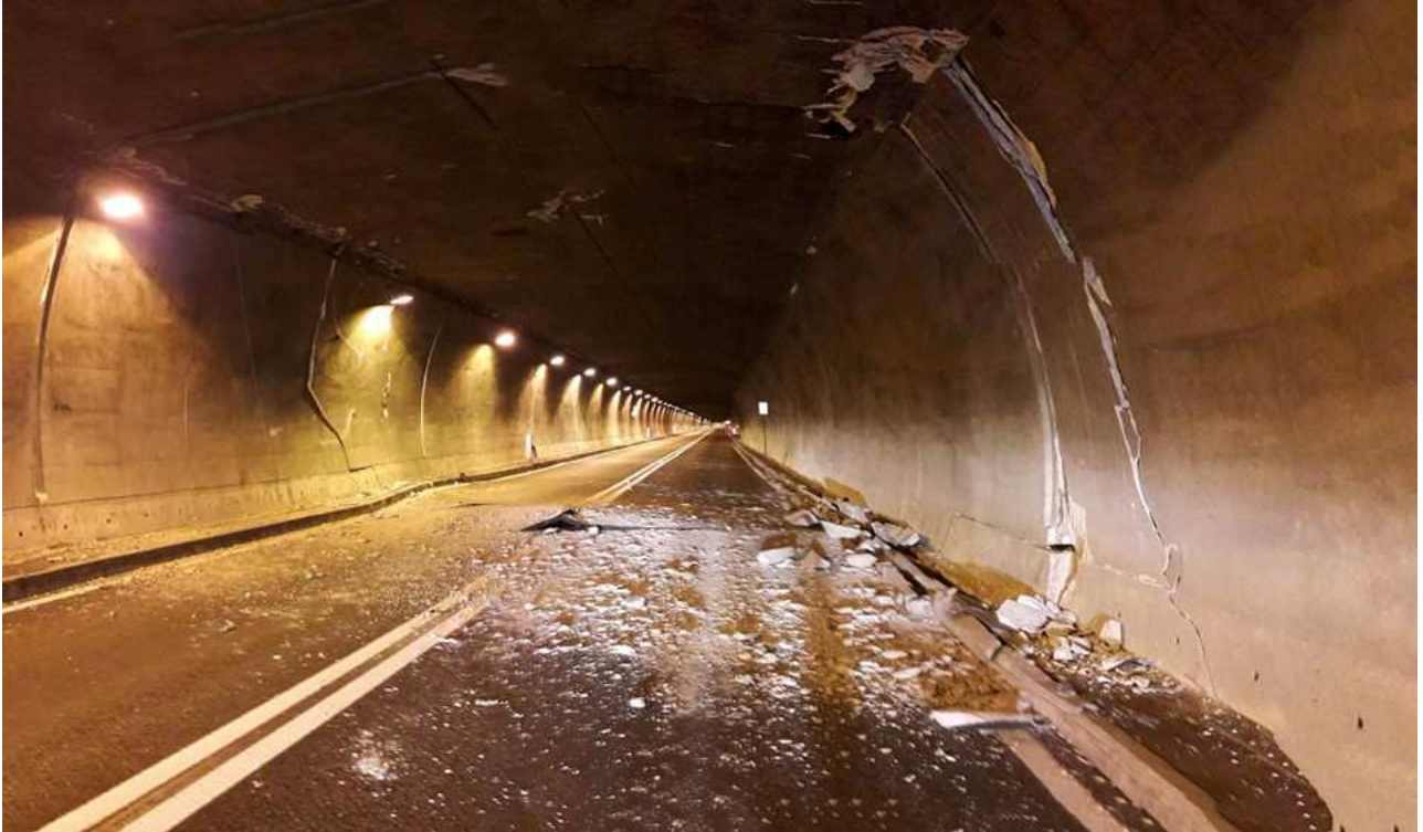
Figura 7: frattura nel rivestimento di una galleria nei pressi di Norcia in seguito ai terremoti succedutisi dal 24 agosto 2016 nell'Italia Centrale. E' intuibile l'entità dei danni che fenomeni simili possono causare su tubazioni verticali ed orizzontali e sugli impianti anche se realizzati nel rispetto della legge antisismica vigente.
