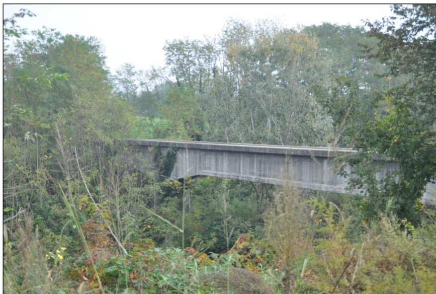
Figura 3.1/8 Il ponte canale a cui vengono staffati i cavi della linea T. 213
