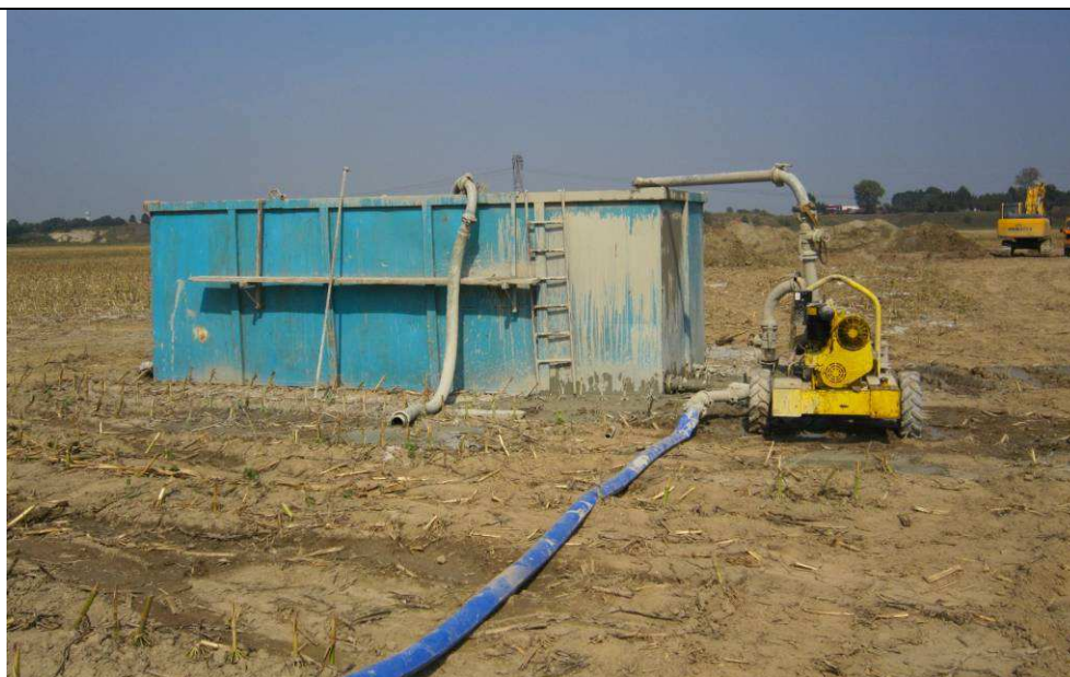
Figura 75: Allestimento di un impianto a circuito chiuso per la realizzazione di pali trivellati mediante l'utilizzo di fanghi bentonitici.
