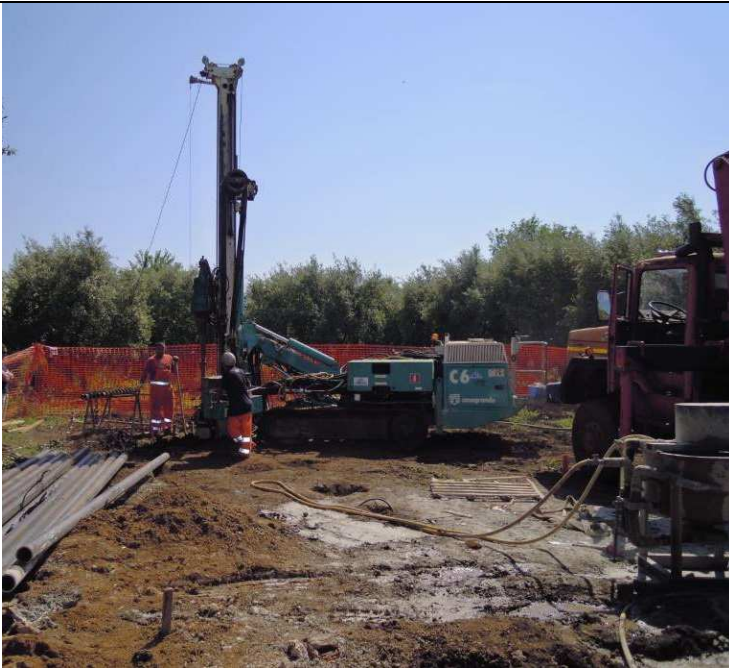
Figura 79: Cantiere per la realizzazione di micropali tipo tubfix; si può osservare sulla sinistra la zona di deposito dei tubolari metallici i quali costituiranno l'armatura dei micropali e sulla destra il miscelatore per la preparazione della boiaccia di cemento per l'iniezione a gravità dei micropali
