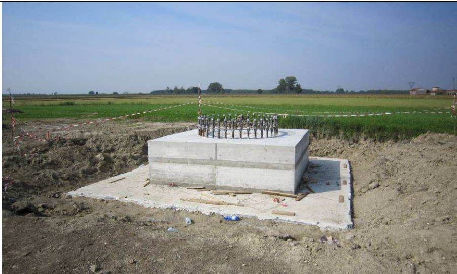
Figura 56: Realizzazione di fondazioni superficiali tipo plinto a monoblocco per un sostegno monostelo. Nell’immagine si può osservare una fondazione appena realizzata. Si può distinguere facilmente la flangia metallica dotata di tirafondi di raccordo con la parte in elevazione
