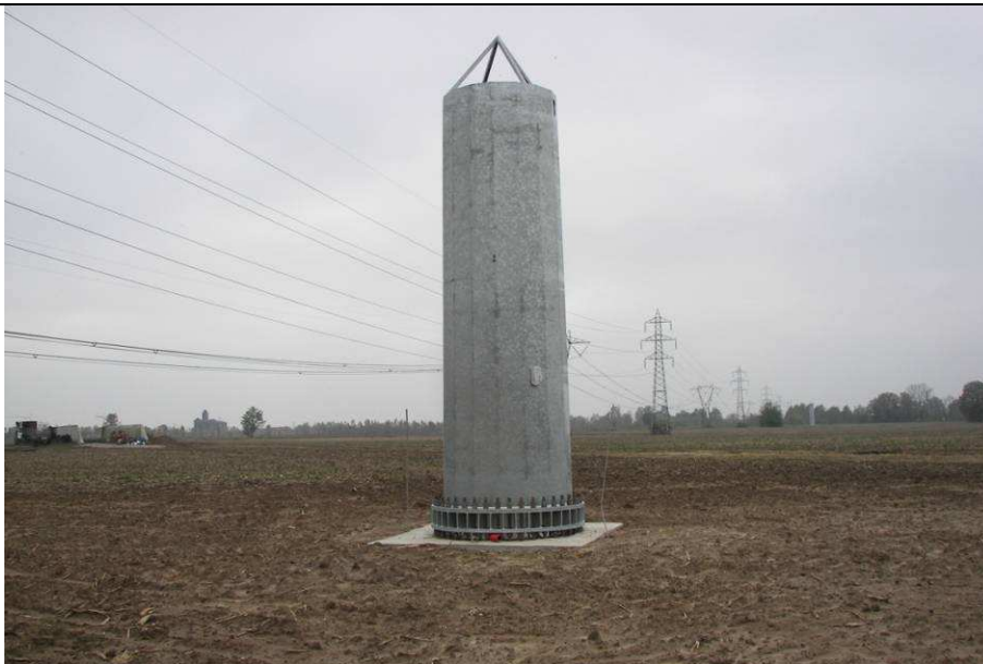
Figura 57: Realizzazione di fondazioni superficiali tipo plinto a monoblocco per un sostegno monostelo. Nell’immagine è riportato un esempio di fondazione completata e la sistemazione del terreno nell’area circostante.
