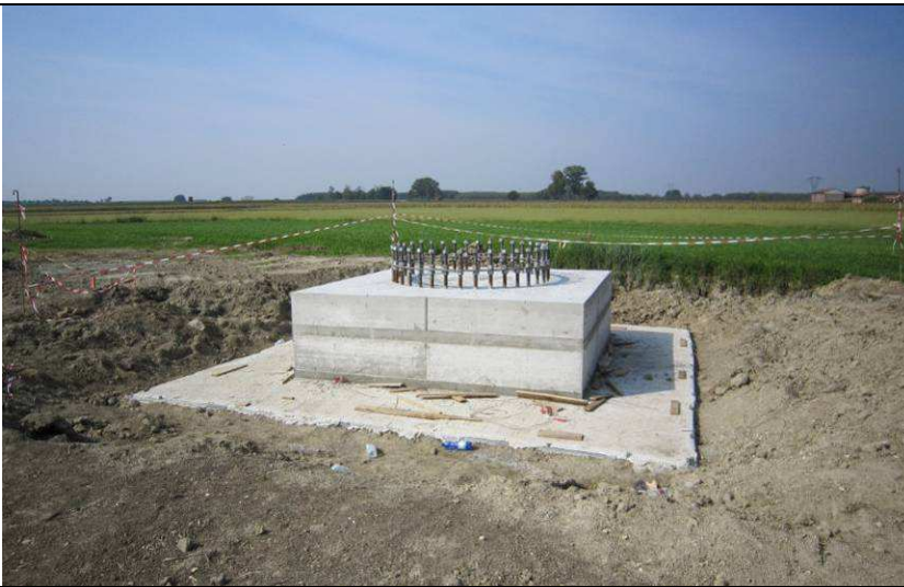
Figura 66: Realizzazione di fondazioni superficiali tipo plinto a monoblocco per un sostegno monostelo.
