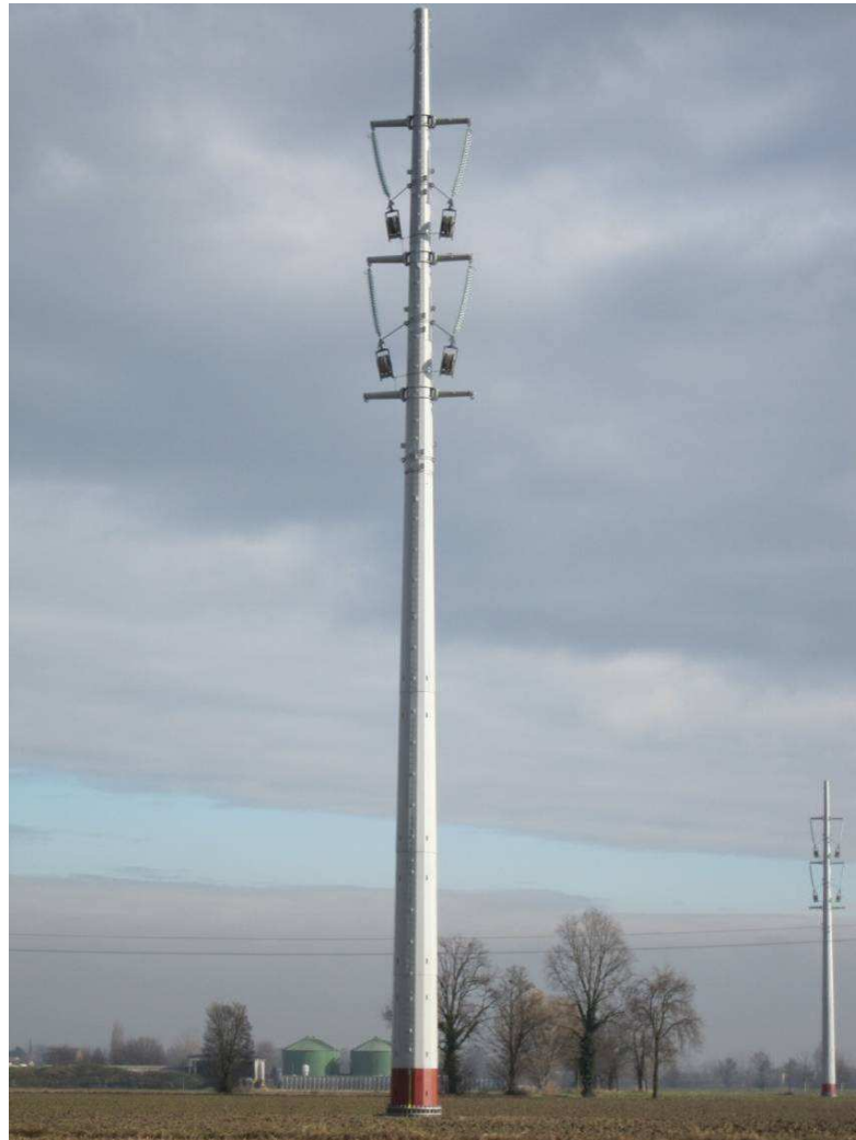
Figura 58: Sostegno monostelo montato. Si notino le carrucole collegate alle catene degli isolatori, fase che precede la “tesatura” dei conduttori
