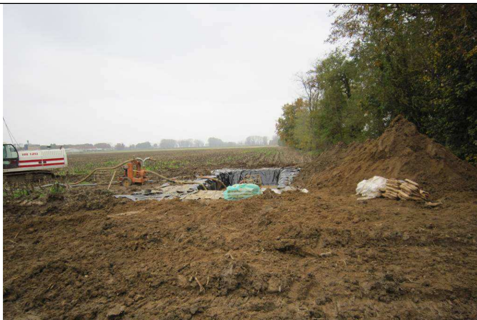
Figura 74: Allestimento di un impianto a circuito chiuso per la realizzazione di pali trivellati mediante l'utilizzo di fanghi bentonitici. In questa immagine si osservano la vasca impermeabilizzata per la decantazione del fango, la pompa di rilancio del fango verso il foro e l'area di deposito dei sacchi contenenti la bentonite
