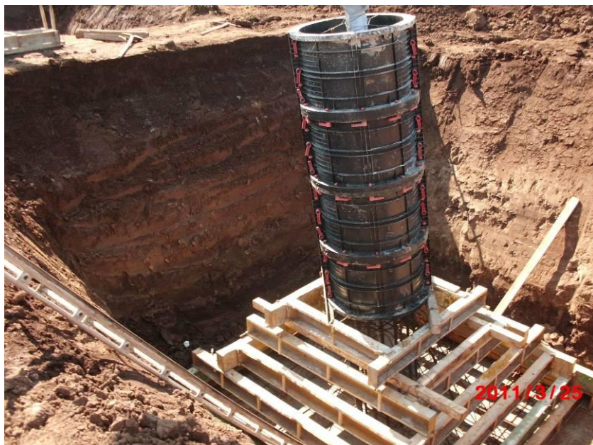
Realizzazione di fondazioni superficiali tipo CR per un sostegno a traliccio. Nell'immagine si può osservare la fase di cassetatura
