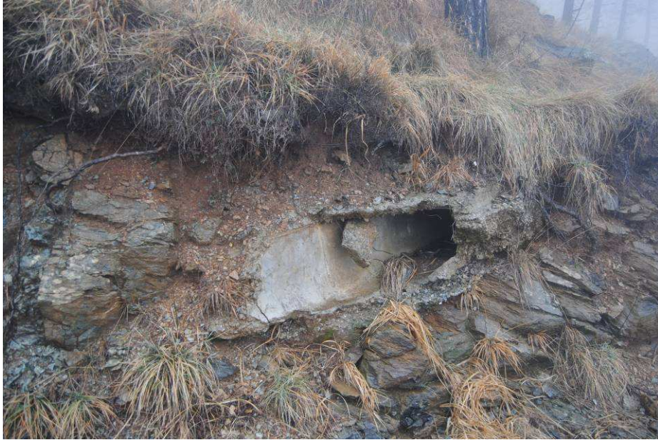
Figura 6 Vecchio canale in calcestruzzo, abbandonato, di adduzione verso l'invaso
