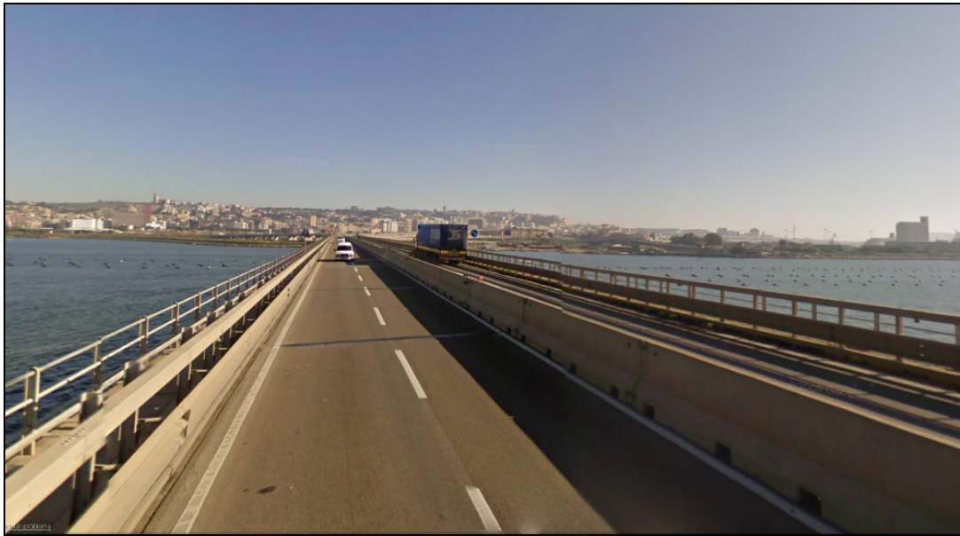
Figura 3-4 SS 195 Viabilità collegamento porto canale con il porto vecchio (punto 1 mappa Figura 3-3)
