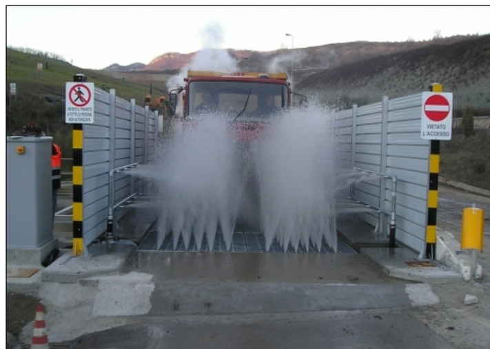
Figura D-3 Impianto di lavaggio dei mezzi di cantiere
