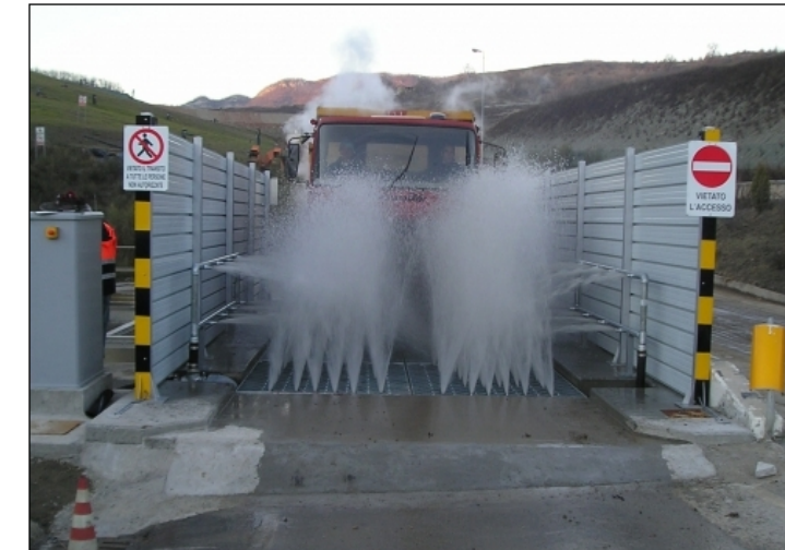
Figura D-2 Impianto di lavaggio dei mezzi di cantiere
