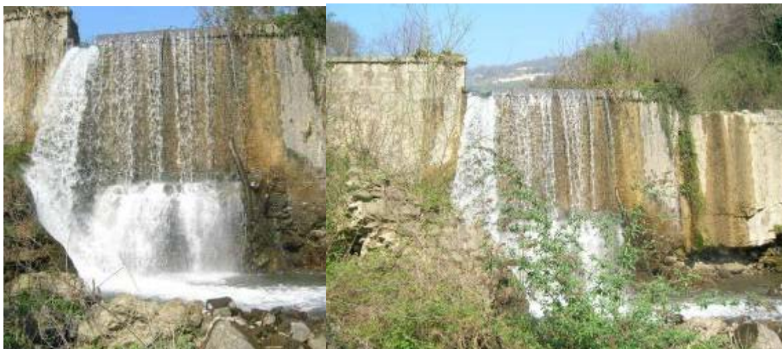
Figura 2.2.12 – Fotografie dello scavo al piede della briglia a monte dell'opera di presa dell'invaso della Giudea.
