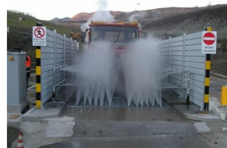
figura 4-9 - impianto per il lavaggio delle ruote
