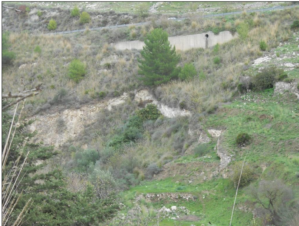
Foto B.1 - Panoramica del dissesto; visibile sulla parte alta della foto il muro con il foro del tombino e la sovrastante SS514.
