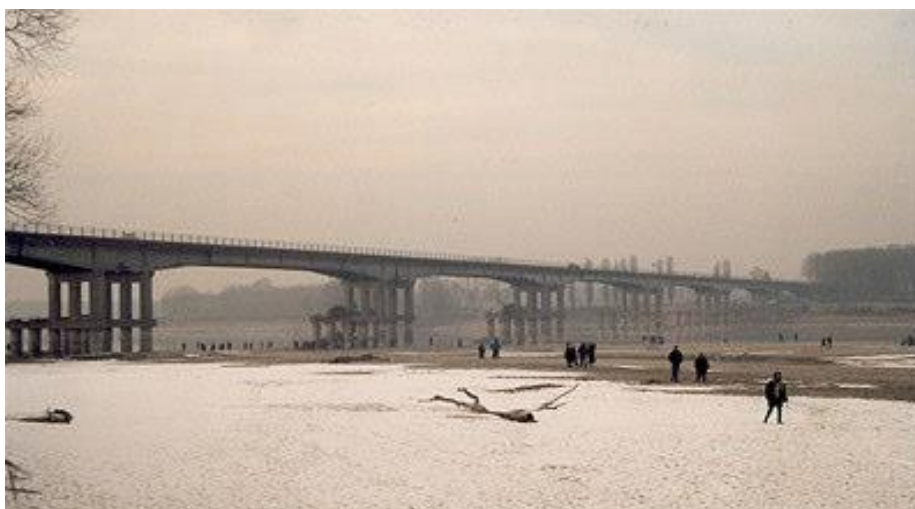
Figura D.4: Esempio di erosione generalizzata sul fiume Po
