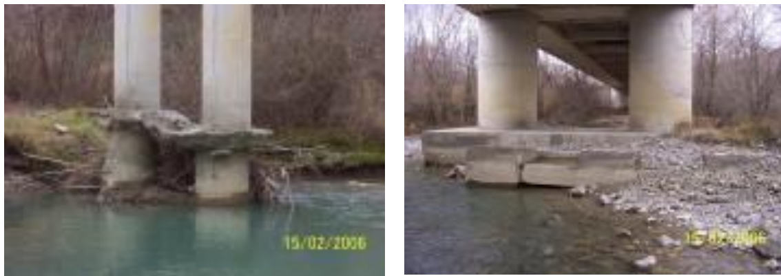
Figura D.6: esempi del fenomeno di erosione localizzata alla base delle pile
