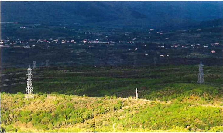
Img1. Panoramica sull' Elettrodotto in doppia terna Laino-Rizziconi e i due "gemelli" Laino Rossano (da dismettere)
