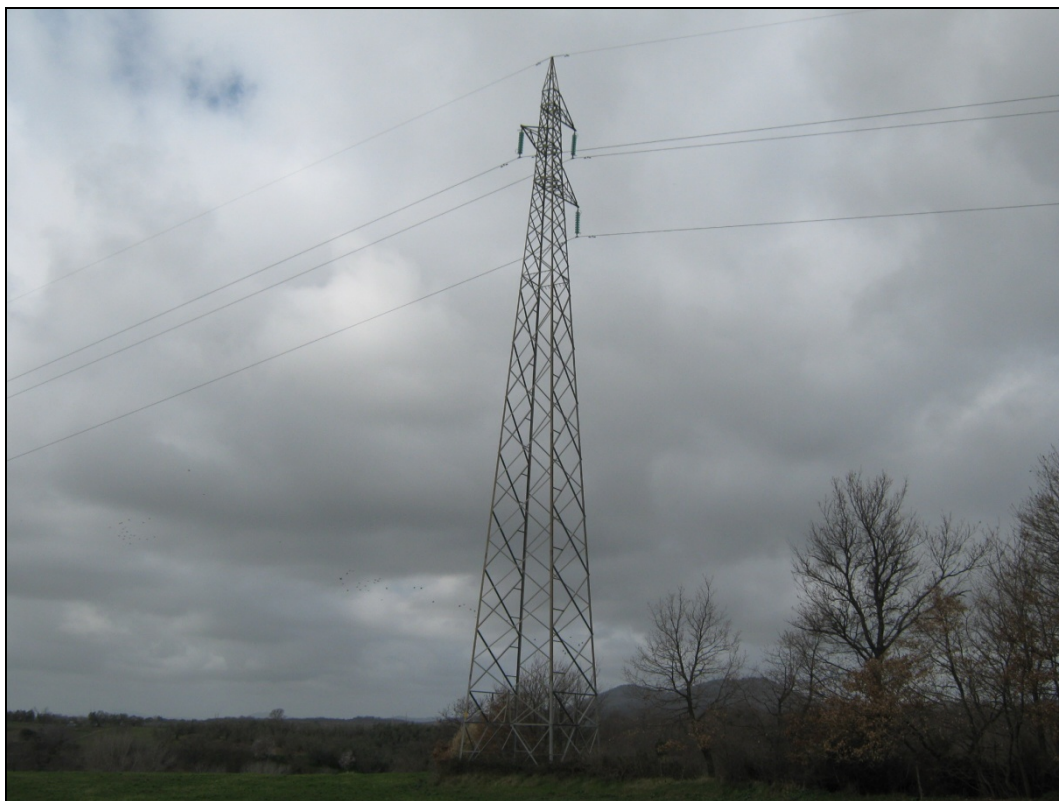
Foto 7: Area allaccio con sostegno dell'Elettrodotto Canino – Arlena
