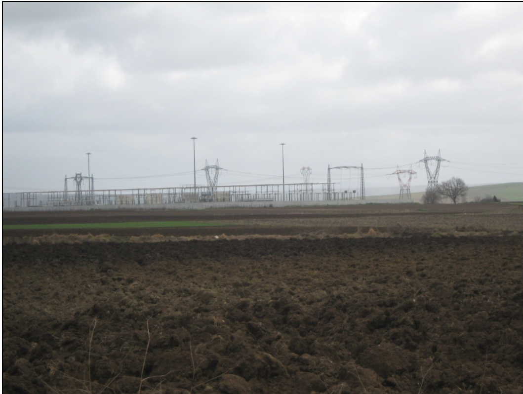
Foto 1: Vista di insieme della S.E. di Tuscania – Area Sostegni nn. 1÷4
