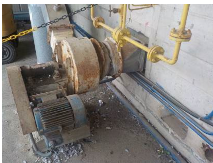
Figura 5-17 - Estrattore Impianto di ventilazione vecchie fosse
