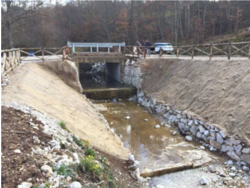
Figura 3-5: Nuovo manufatto idraulico in corrispondenza del Vallone Guagliarello
