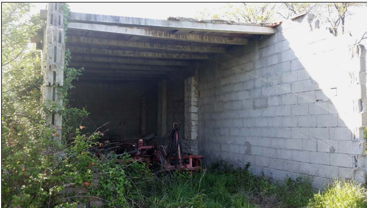
Figura 3: Ricettore R6 "Podere Casanuova": deposito attrezzi abbandonato
