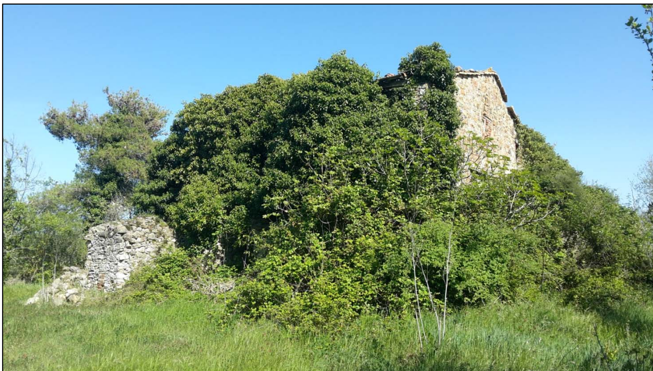
Figura 4: Ricettore R6 "Podere Casanuova": edificio rurale crollato (rudere disabitato)
