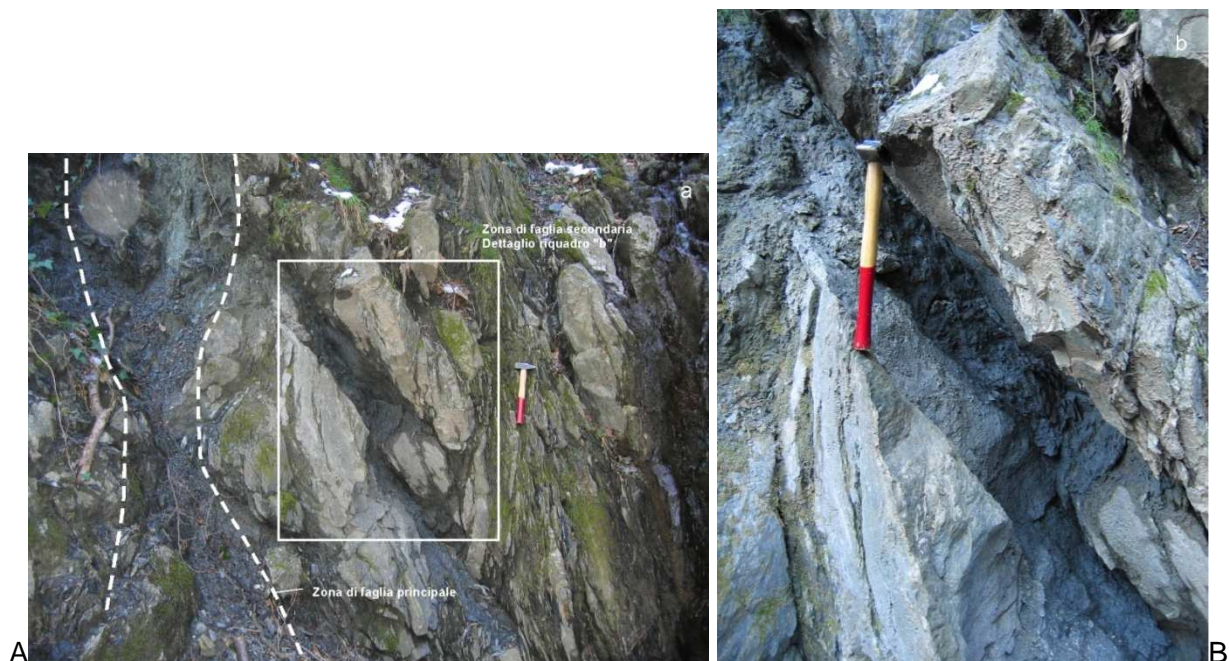
Figura 20 - Faglia all'interno degli argilloscisti nei dintorni di Case Noage (progressiva della Galleria di Valico 9+700 ca.). Si notino le superfici di movimento caratterizzate da gouge non coesivo.
