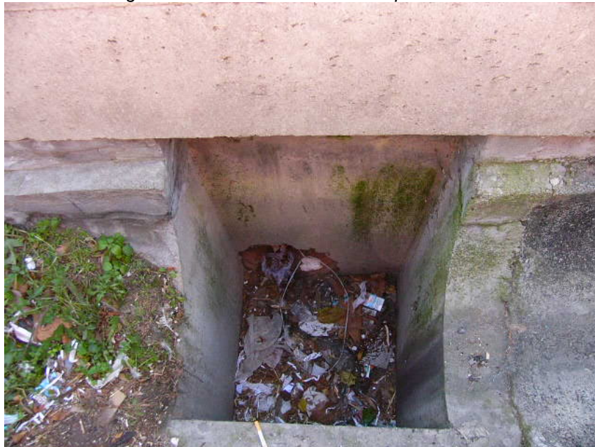
Figura 4.1: Pozzetti di scarico complanare Sud
