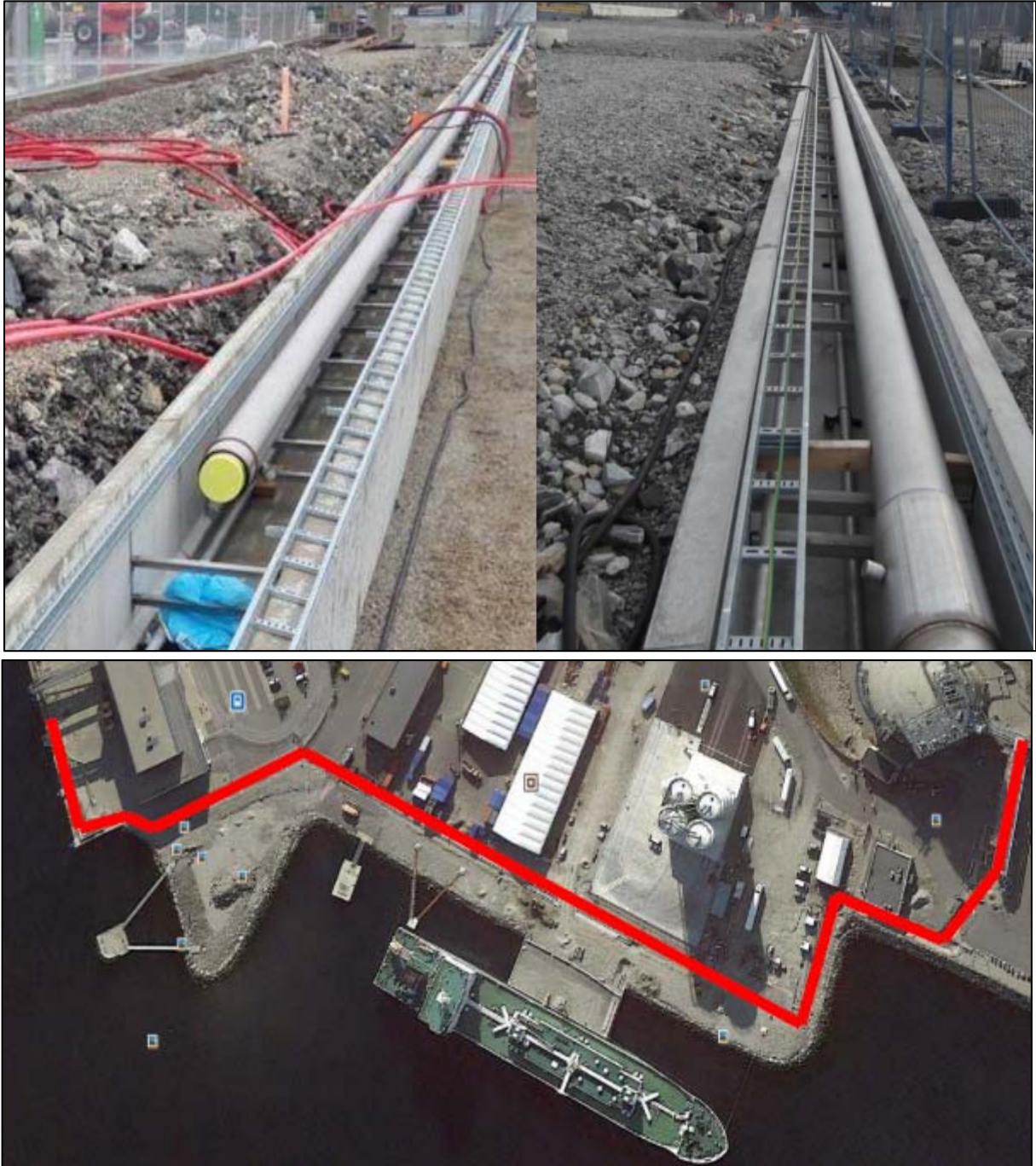
Figura 8: Impianto di Risavika (Norvegia) con cunicolo di passaggio tubazioni tipo VIP
