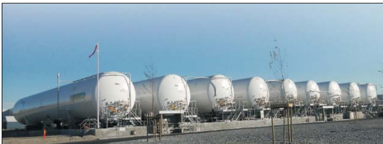
Figura 12: Esempio di serbatoi criogenici (impianto GNL a Fredrikstad – Norvegia)
