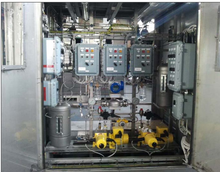
Figura 22: Sistema di Odorizzazione
