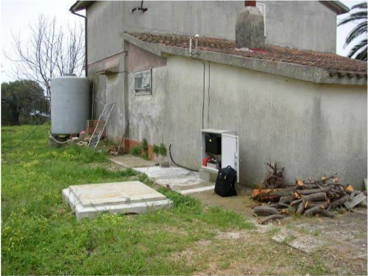
Figura 17 - Armadietto con la strumentazione installato sul retro di un garage e pozzetto del sensore.
