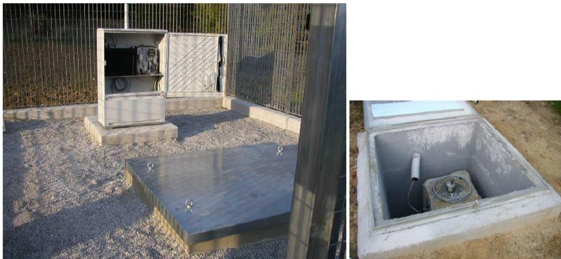
Figura 16 - Esempio di alloggiamento della strumentazione nell'armadietto e del sensore all'interno del pozzetto.
