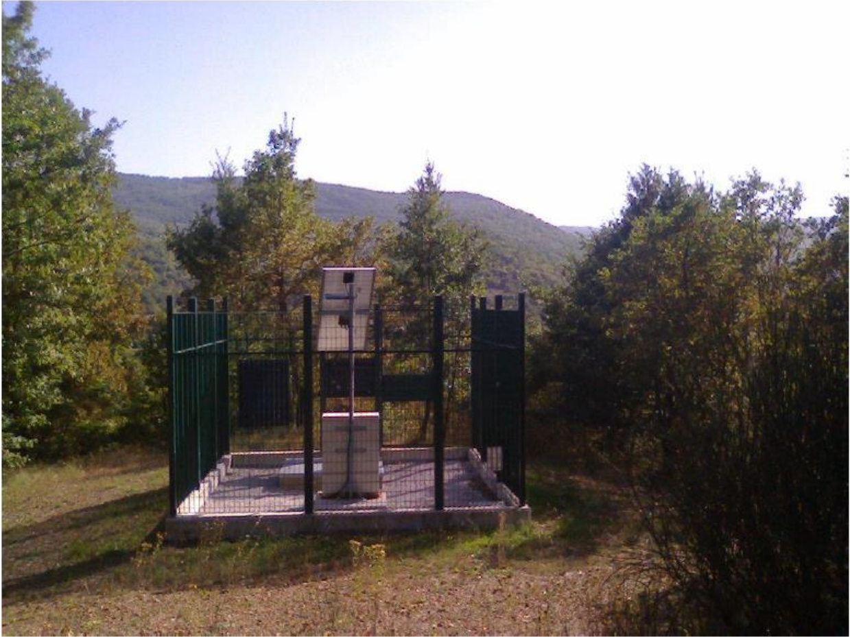
Figura 156 - Esempio di stazione microsismica installata in zone remote con alimentazione con pannello fotovoltaico
