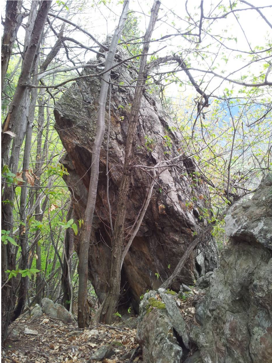
Fig. 31 –Esempio di masso ciclopico “piantato” nel terreno da monitorare attraverso l’installazione di clinometri e misuratori di giunti.
