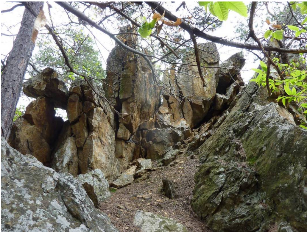
Fig. 33 – Porzione di substrato disarticolato con massi instabili per crollo e ribaltamento, da monitorare attraverso clinometri, fessurimetri e misuratori di giunti.
