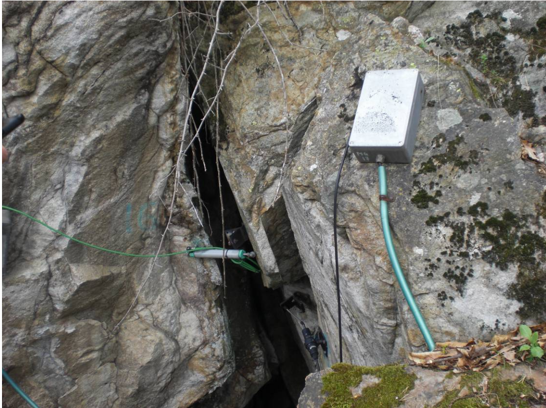
Fig. 5 – Misuratore di giunti (rete monitoraggio della Musinet).
