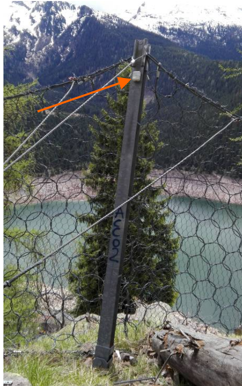
Fig. 36 –Esempio di accelerometro triassiale installato sul puntone di sostegno di una barriera paramassi.
