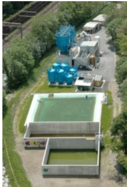
Esempio di impianto trattamento acque di cantiere
