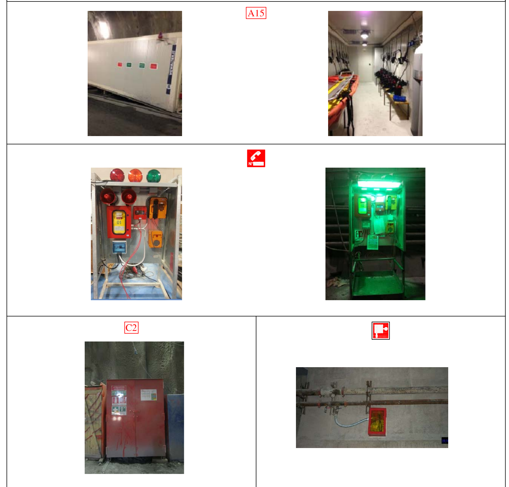
EQUIPEMENTS LUTTE CONTRE L'INCENDIE / GESTION DES SITUATIONS D'URGENCE (PHOTOS TYPOLOGIQUES) ATTREZZATURA ANTINCENDIO / GESTIONE EMERGENZE (FOTOGRAFIE TIPOLOGICHE)
