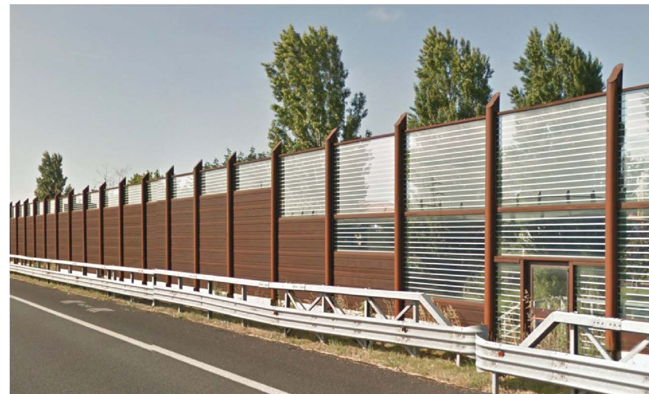
Figura 2-2. Autostrada A14 Tratto Rimini – Cattolica, con montanti carterati, con taglio sommitale a becco di flauto
