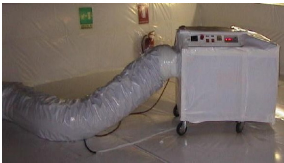
ESTRATTORE ALL'INTERNO DELL'AREA CONFINATA
