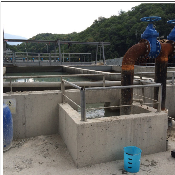
Foto 1. Impianto di trattamento
