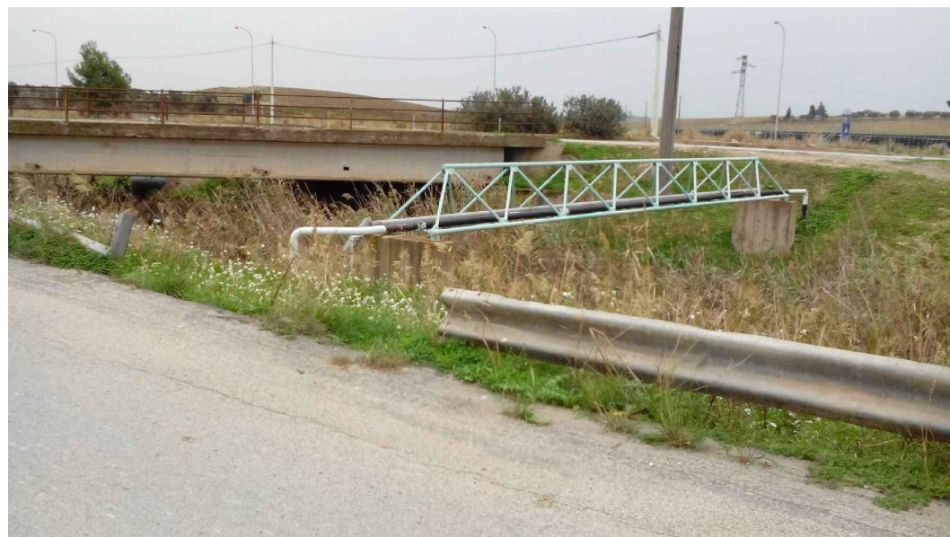
FOTO 15 Canale con condotta - Vista da strada a nord del Canale verso sud
