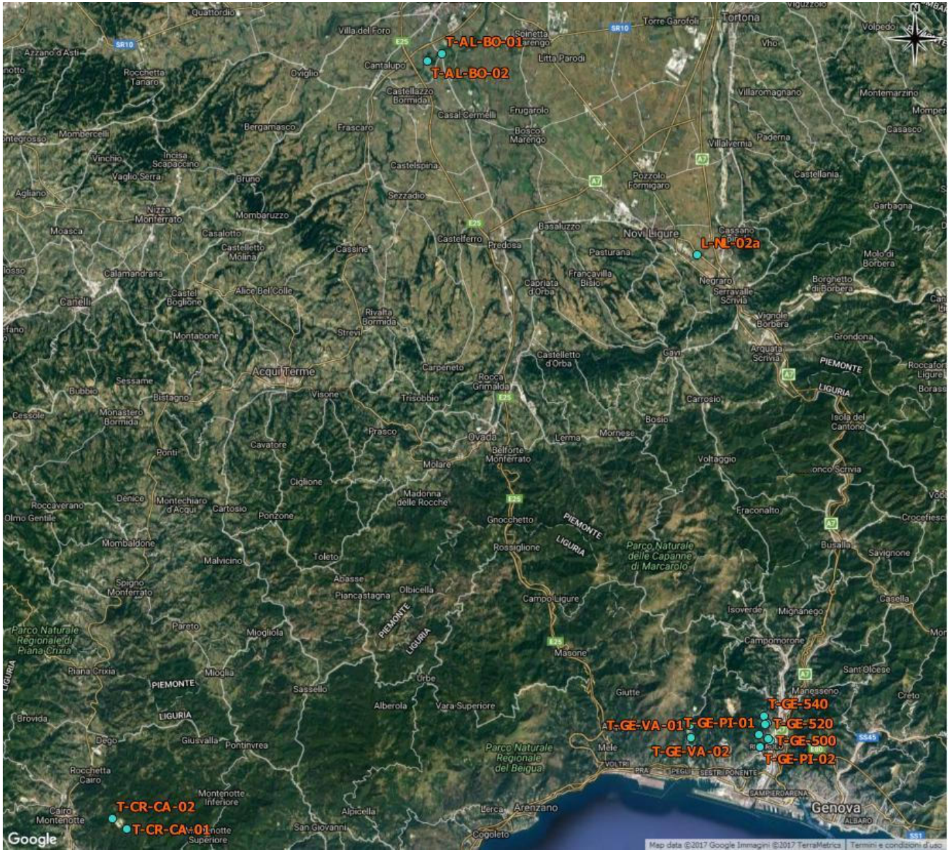
Figura 3.1 - Visione d'insieme delle stazioni di monitoraggio della tratta A.V./A.C. Milano-Genova, Terzo Valico dei Giovi
