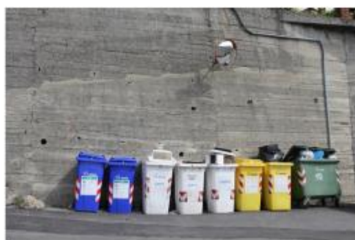
Muro di contenimento Stato di manutenzione: D Localizzazione di massima: Y: 4922061.94 m N X: 491013.48 m E
