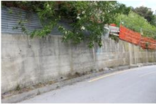
Muro di contenimento Stato di manutenzione: D Localizzazione di massima: Y: 4921961.51 m N
