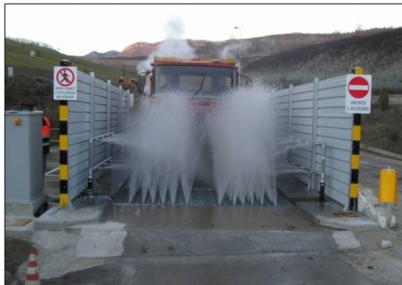
Figura 7 - Impianto lavaggio ruote
