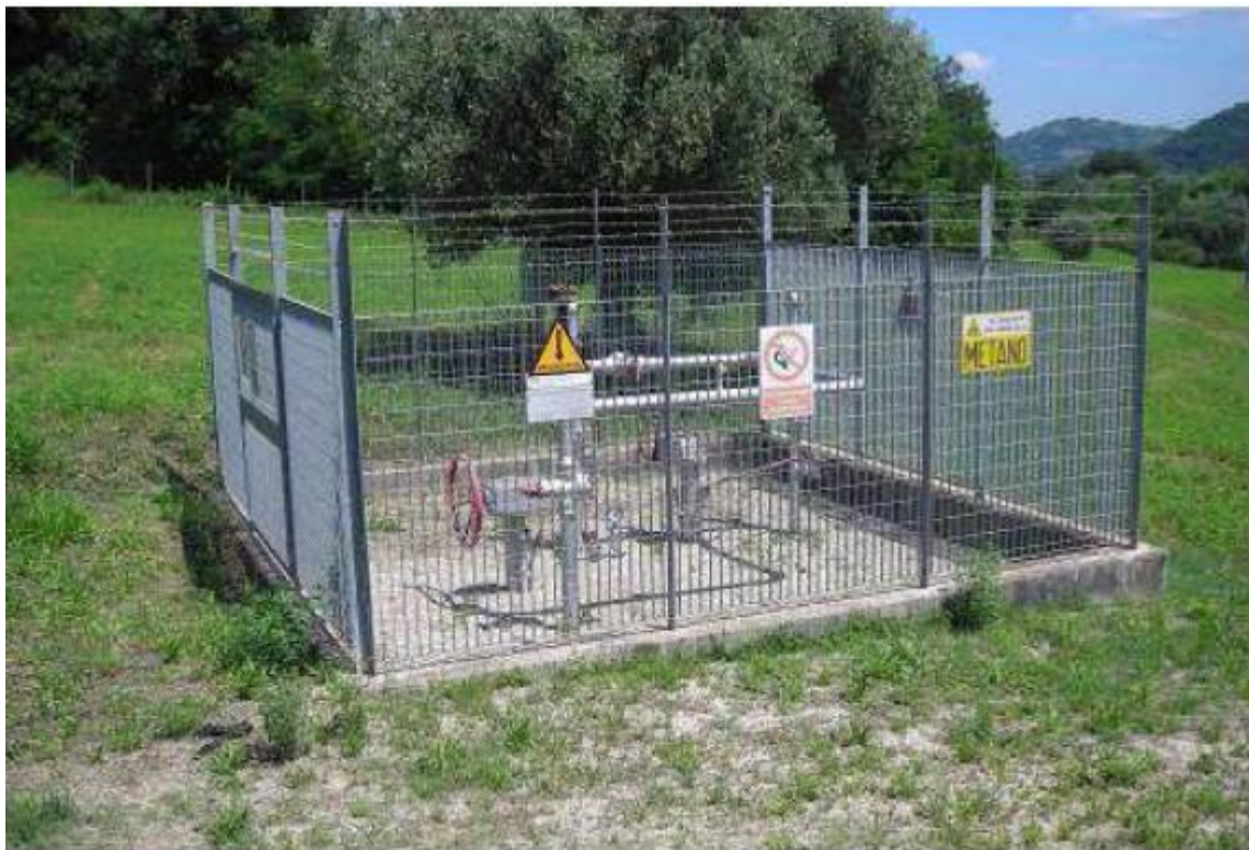
Fig. 5/J: Esempio di punto di linea (unico elemento fuori terra a lavori ultimati, oltre ai cartelli segnalatori)
