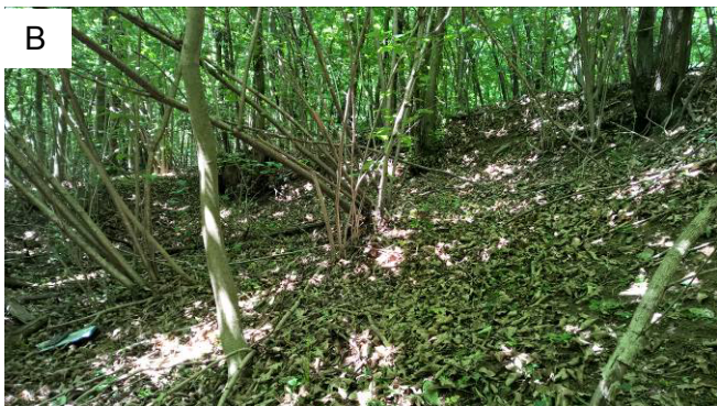
A – Area di fondazione prevista per nuovo sostegno (su piano inclinato, freccia rossa). A destra rio secco con ciottoli decimetrici (freccia azzurra) B – Piano di appoggio delle fondazioni inclinato. Si suggerisce di spostare il traliccio di circa 30 m a Est, su terreno pianeggiante e distante da rio
