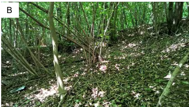
A – Area di fondazione prevista per nuovo sostegno (su piano inclinato, freccia rossa). A destra rio secco con ciottoli decimetrici (freccia azzurra) B – Piano di appoggio delle fondazioni inclinato. Si suggerisce di spostare il traliccio di circa 30 m a Est, su terreno pianeggiante e distante da rio
