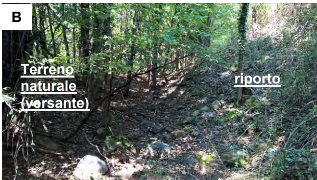
A – Area di fondazione nuovo sostegno (freccia rossa). La freccia azzurra indica la presenza di terreno di riporto (pietrame, probabile smarino) B – Contropendenza tra il riporto detritico e il versante. Presenza di numerosi blocchi decimetrici
