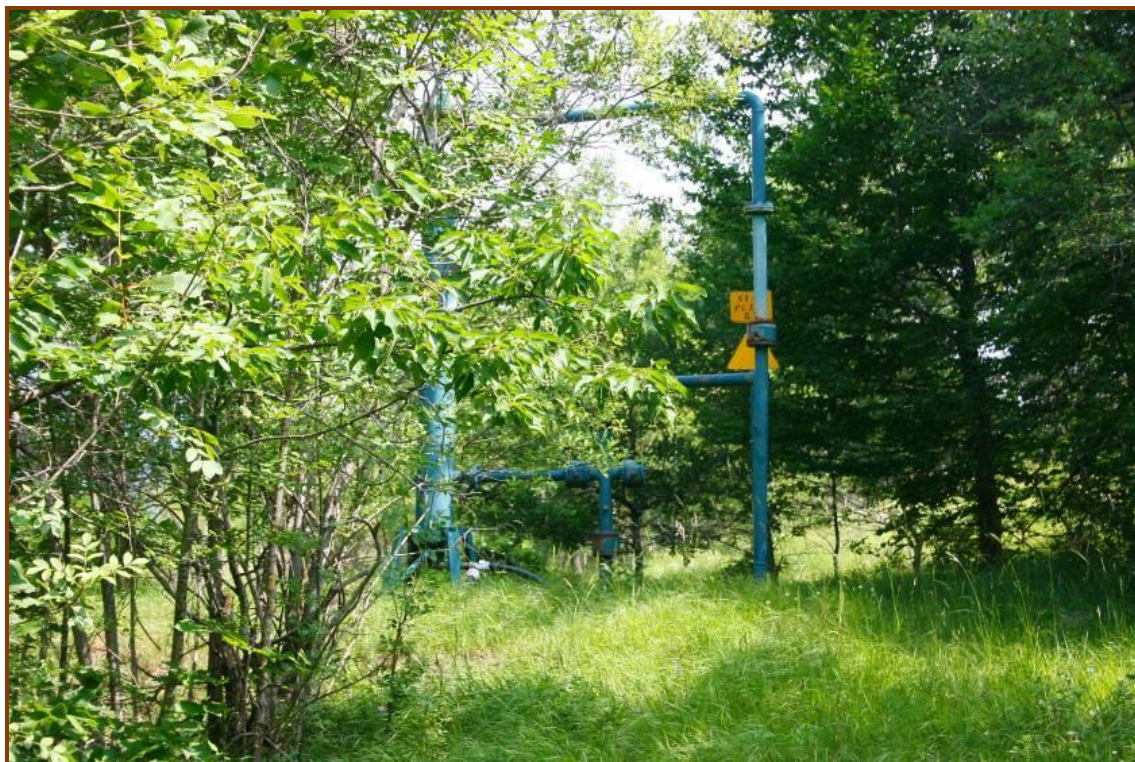
Fig. 8 – Pozzo SIAM. Le ridotte dimensioni dell'area occupata, nonché le forme allungate e l'uso dei colori appropriati, consentono di mimetizzare il manufatto che, già a breve distanza, tende a confondersi con la vegetazione spontanea.
