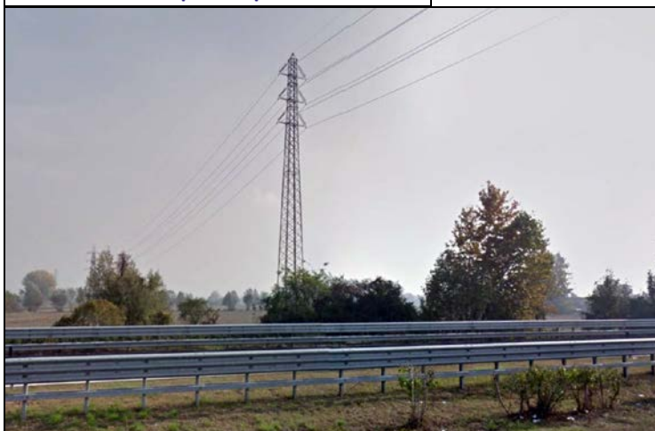
Traliccio del tipo "leggero" a base stretta: particolari costruttivi e fotografia di linea simile già realizzata (in doppia terna, quella in progetto risulta invece in semplice terna quindi ancora meno impattante)
