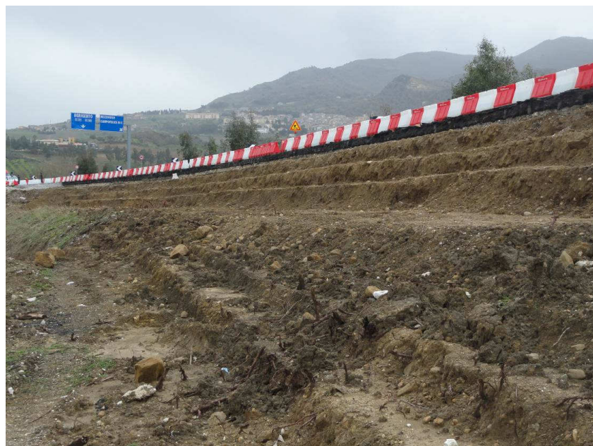
Figura 4 – Foto dello stato attuale delle gradonature effettuate sul rilevato AP10 (sopralluogo del 6/02/2015)
