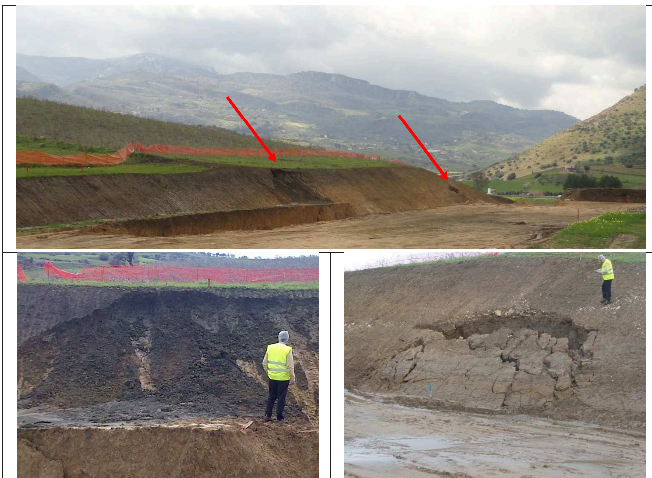
Figura 4 – Instabilità puntuali dei fronti di scavo
