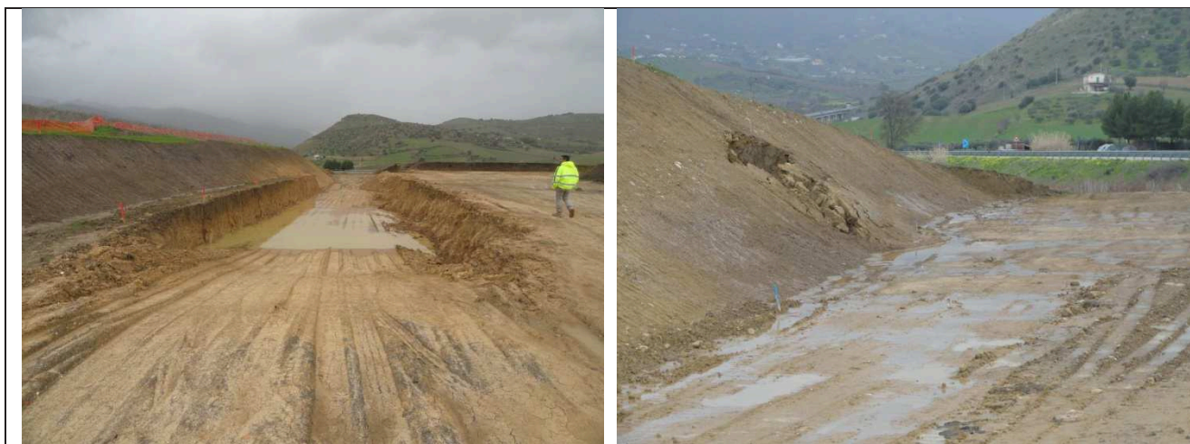
Figura 2 – Difficoltà di drenaggio delle acque meteoriche all'interno dello scavo per il cassonetto stradale (tratto in trincea dell'Asse Princ. Lotto 2A)
