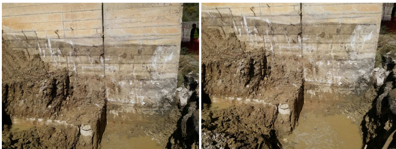
Figura 1 - stato attuale - scavo in corrispondenza della spalla 1 del nuovo portale dx - sottovia esistente/svincolo Mezzojuso
