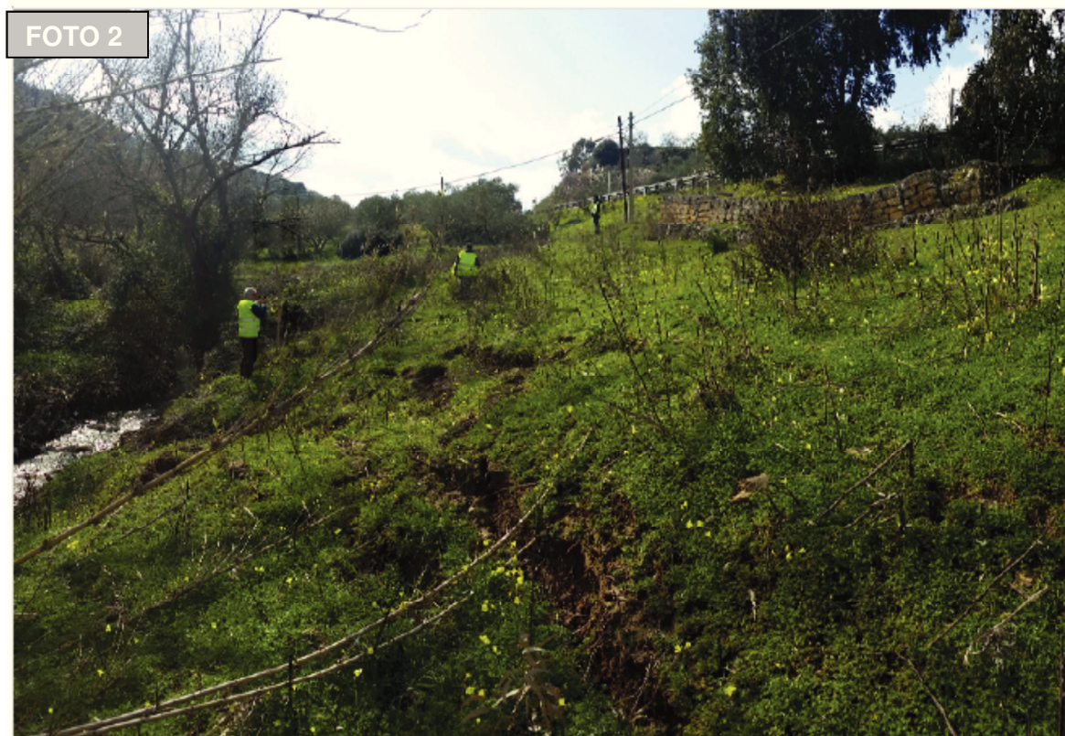
Fig. 4. Foto 2. Evidenti i dissesti dovuti ad erosione di sponda lungo il Fosso Buffa
