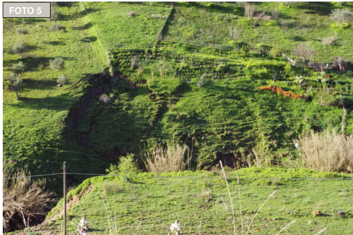
Fig. 7. Foto 5. Disseso sul versante in destra idraulica all'altezza delle sezioni 396 e 397
