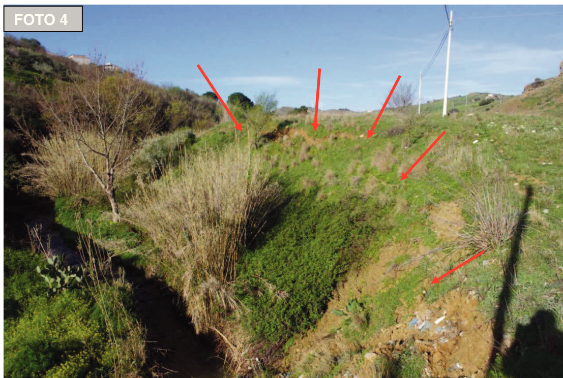
Fig. 6. Foto 4. Dissesto sulla scarpata tra il F. Buffa In basso a sinistra e la SS121 tra le sezioni 396 e 397
