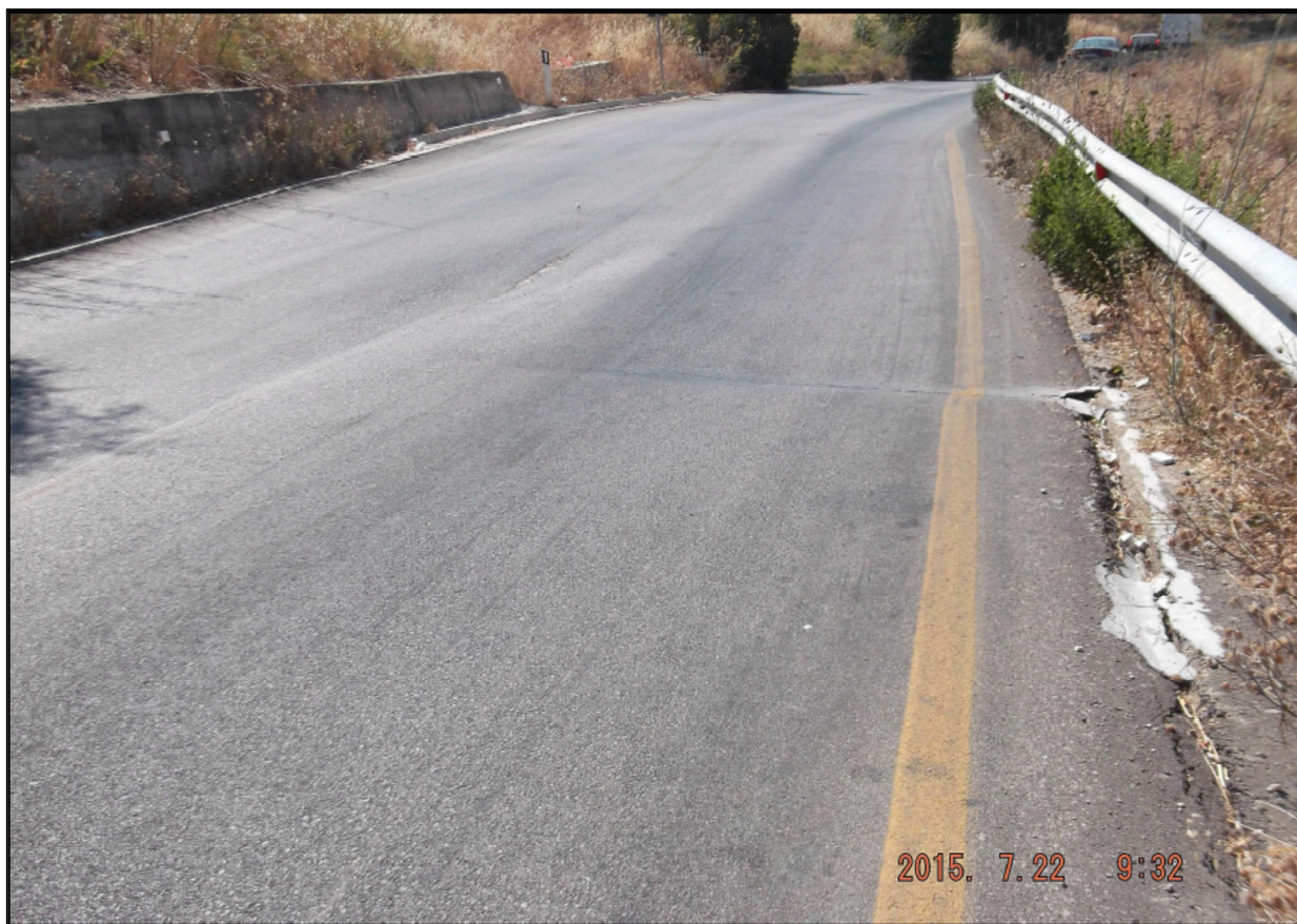
Figura 4 - Vista del cedimento/abbassamento del piano viabile in corrispondenza della sezione n.76-79
