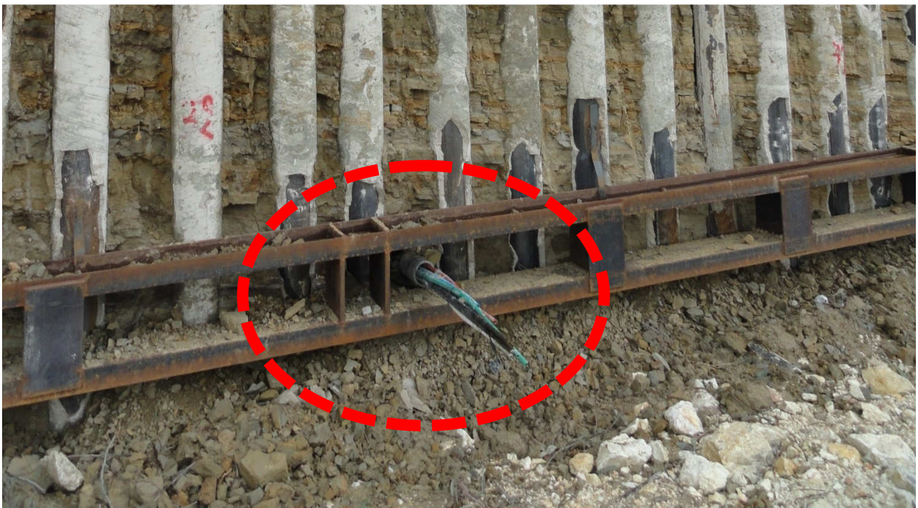
Figura 2-Vista del difetto riscontrato sulla paratia di micropali OS68
